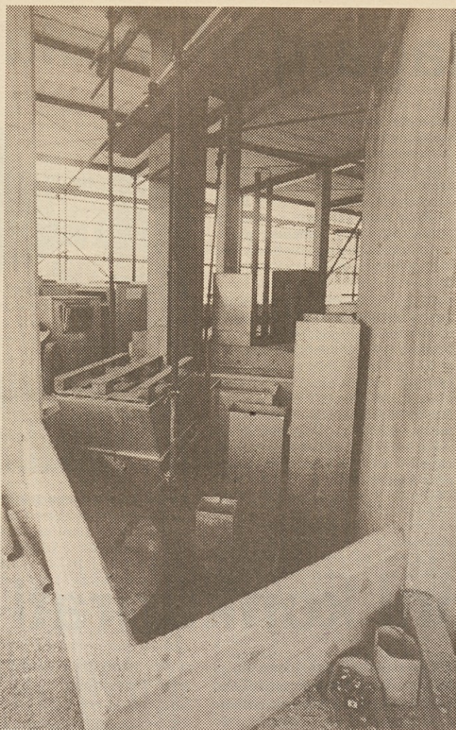
Priključki klimatizacijskih kanalov strojnice na vrhu stolpnice.
