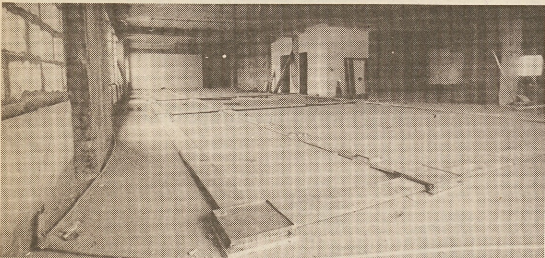
Instalacije v stolpnici so položene v pod, tako električne, kot za centralno gretje.
