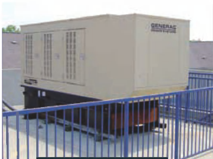
Veliki zasilni dizelski električni generator
