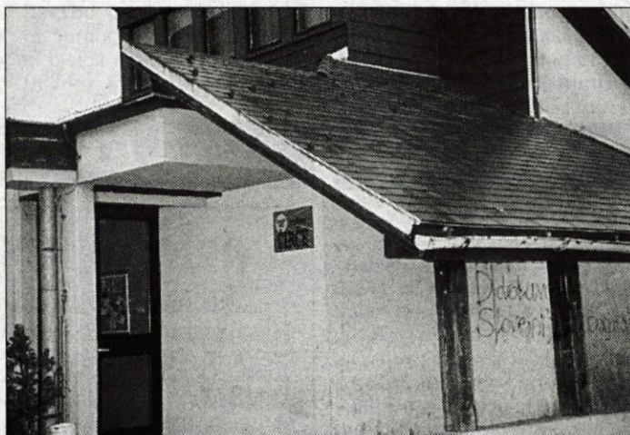
Vrtec Čirče ima streho kot rešeto. Jo bosta še pred naslednjim deževjem popravili KS ali občina?
