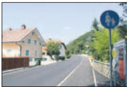
V cestišče so vgradili vso infrastrukturo, položili asfalt ter zgradili enostranski pločnik.
