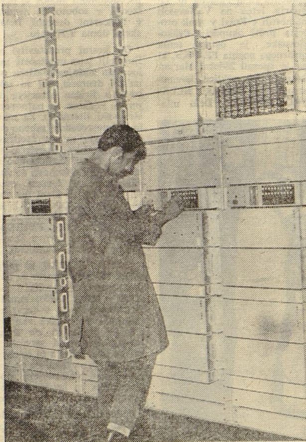
Nova telefonska centrala Karpoš IV. je v Skopju obogatila mestno telefonsko omrežje za 4.000 novih priključkov. ATC je izdelala »Elektromehanika« — ATN, montirali pa so jo monterji PSO.
