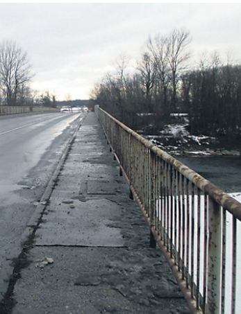
Foto: EM vozišča pločnik za pešce (po njem velika luknja), zato ograja mostu ni
