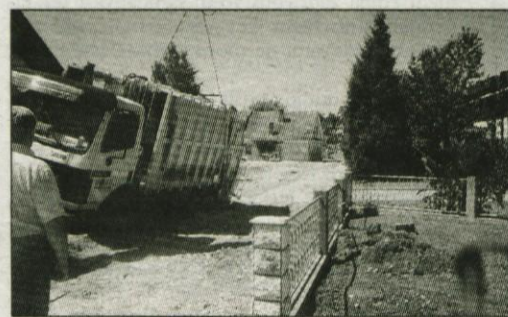
Fotografija nazorno prikazuje, kaj se zgodi, če ni zagotovljen varen dostop specialnim vozilom za pobiranje odpadkov.
