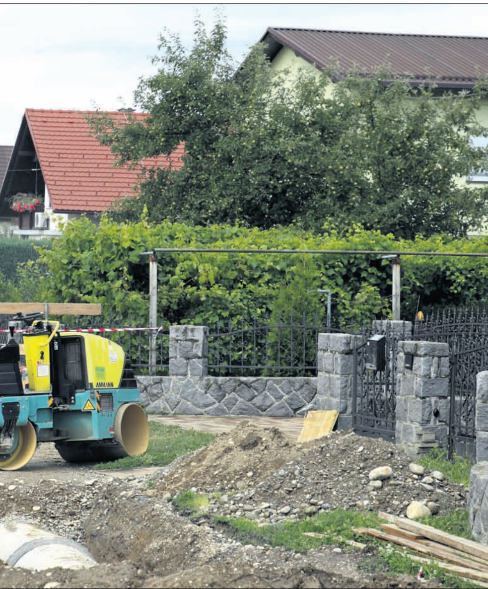
19. junija. Na sanacijo cestišča in vodovodnega omrežja pa bo treba še počakati.
