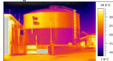
Termogram rezervoarja s tekočino
