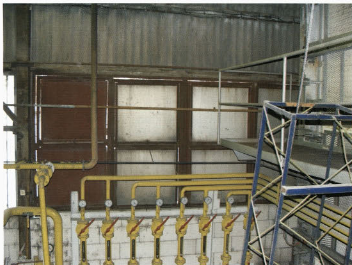
Stara kovinska okna, ki so težka in po odprtju nevarna, da padejo na industrijski tir, ki je zadaj.
