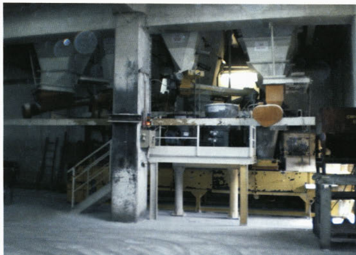
Del postrojenja priprave zmesi
