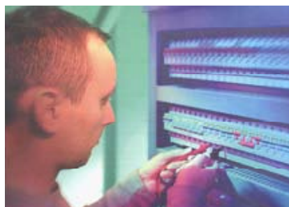
Slika 3: Preverjanje električnih inštalacij lahko izvajajo tudi ustrezno usposobljeni vzdrževalci.
