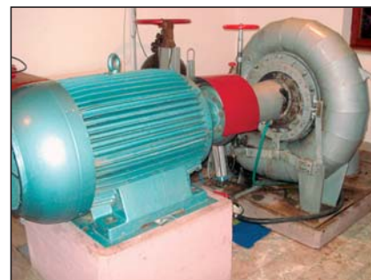
Slika 7. Mala hidroelektrarna moči 70 kW
