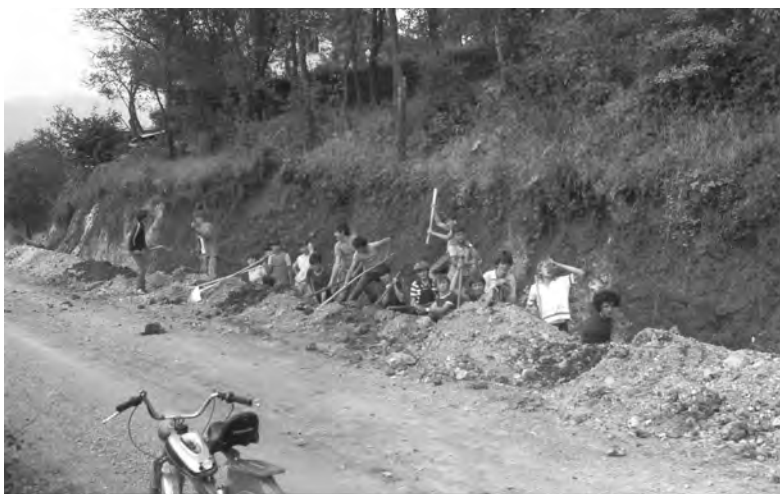
Gradnja ceste v Veliki Ligojni pred asfaltiranjem pod Jamškovo domačijo, lastnika Andreja Novaka, mladinska delovna akcija 1980. leta (foto: Bojan Petrovčič).
