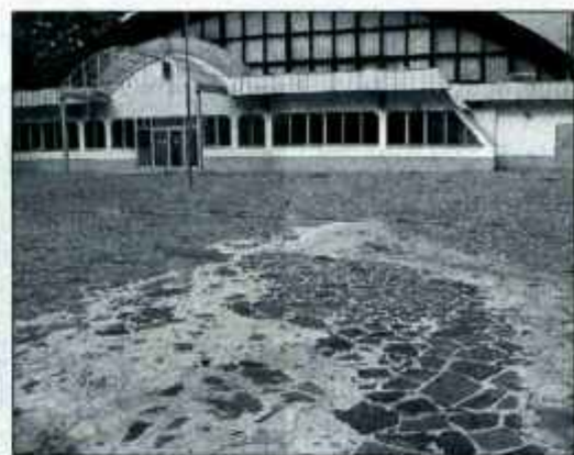
Slabo opravljeno delo - kamniti tlak pred športno dvorano poka in odstopa od podlage, streha na dvorani pa zamaka.
