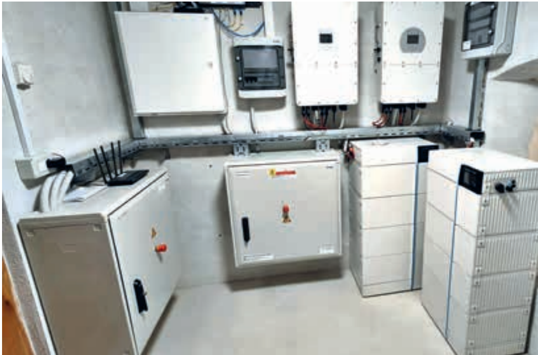
Strojnica sončne elektrarne
