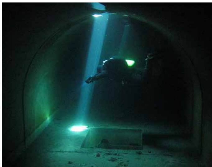
46. slika: Protipožarna podzemna cisterna http://mw2.google.com/mw-panoramio/photos/medium/31796713.jpg
