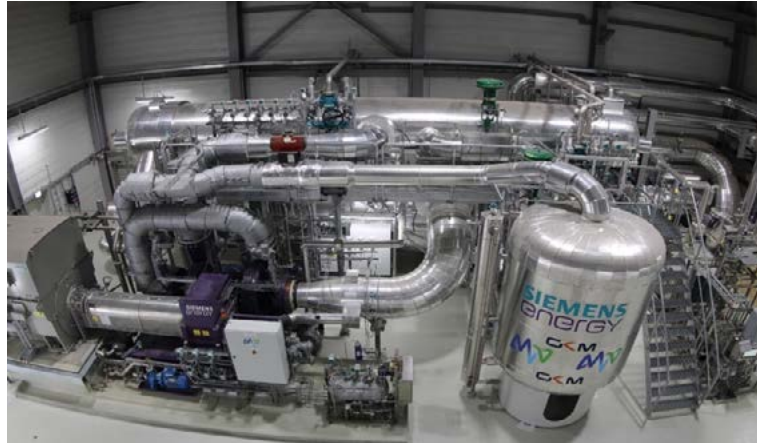
Slika 1: 20 MW toplotna črpalka v obratovanju [4].
