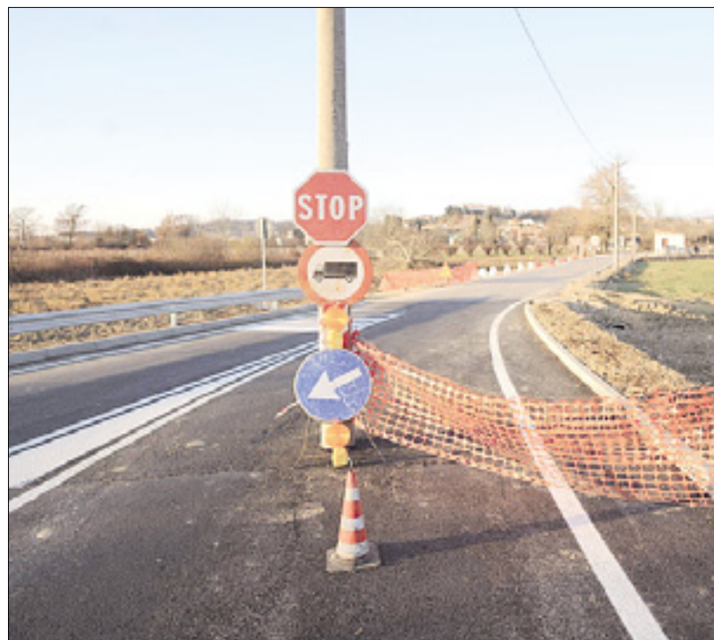
Drog javne razsvetljave sredi ceste med Jazbinami in Vipolžami
