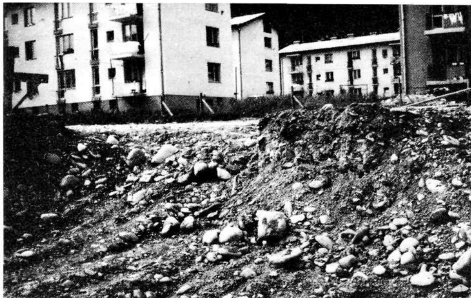
Sl. 3. Slika prikazuje debel in lepo zaobljen prod iz zadnje ledene dobe, ki so ga razkrili v vršaju Češnjice pri izkopu temeljev za nove stanovanjske bloke na Češnjici
