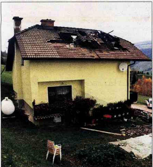
Pred kratkim obnovljeno zgornjo etažo hiše čaka najprej temeljito čiščenje zgozelenih sob, sušenje prostorov in nakup novega ostrešja in oken.
