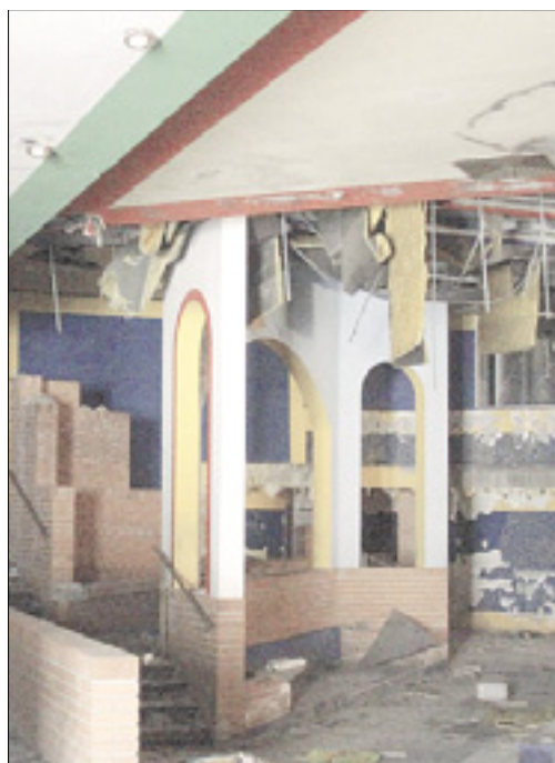
Degradirana notranjost nekdanjega diska BONAVENTURA
