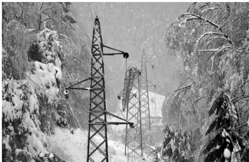
Poškodovan daljnovod pri Podsmreki
