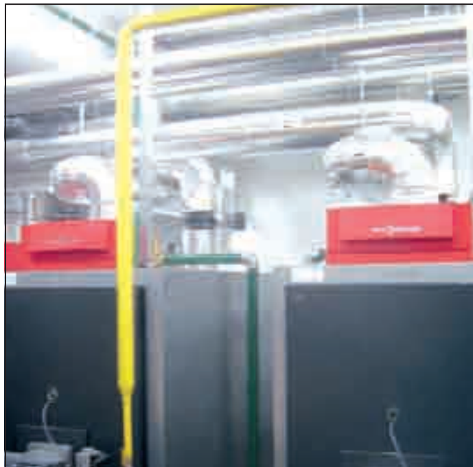
Novi energetsko varčni nizkotemperaturni kotli na plin v OŠ Ivana Cankarja. Foto: Vinko Bizjak
