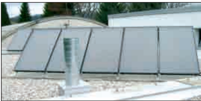
Sončni kolektorji za ogrevanje tople sanitarne vode na novem vrtcu. Foto: arhiv Občine Vrhnika
