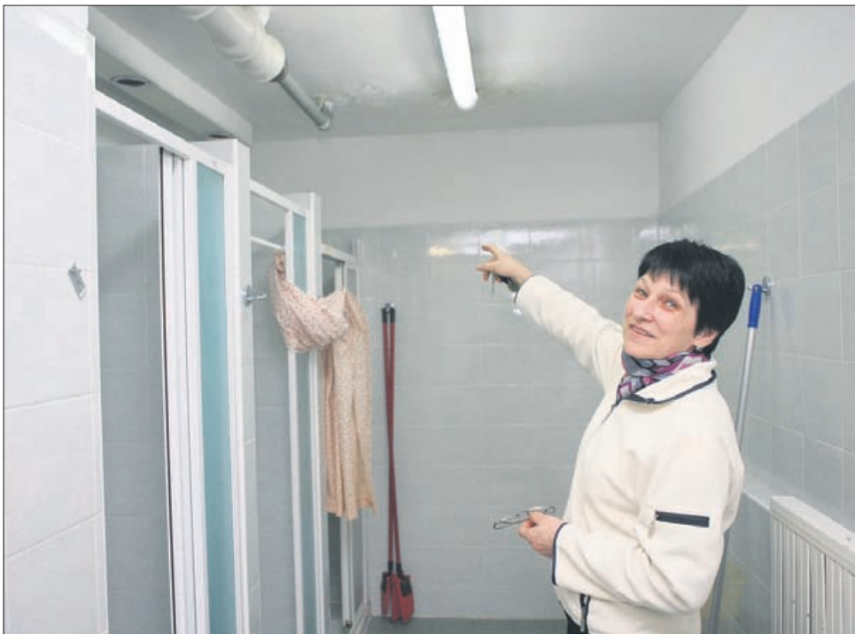
Tuš kabine, umivalniki in stranišča so brezhibno čisti, res pa se zaradi zamakanja vode s sten ponekod lušči omet. Tudi cevi, ki so jih med »krpanjem« kanalizacije takole speljali pod stropom, niso v prid domskemu videzu.
