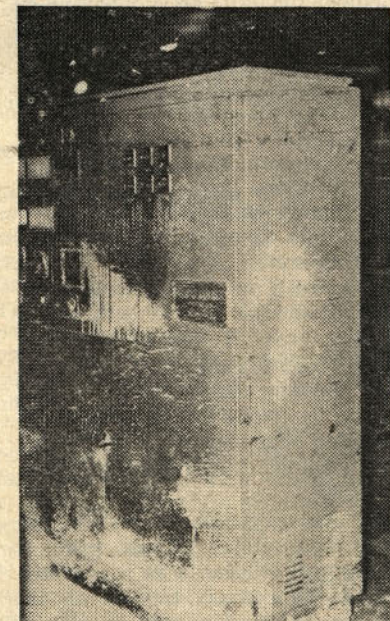
Ze drugič je nastal požar zaradi malomarnosti. Poškodovana razdelilna postaja
