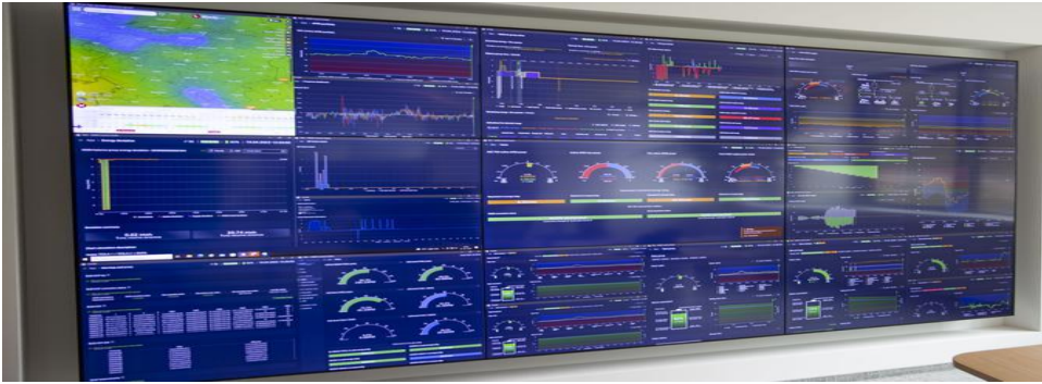
Slika 4: Nadzorna soba energetske skupnosti (Vir: lastni Javeršek, 2025)
