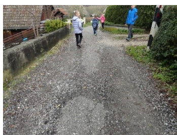
Slika 10: Razpokan in nagrbančen asfalt
