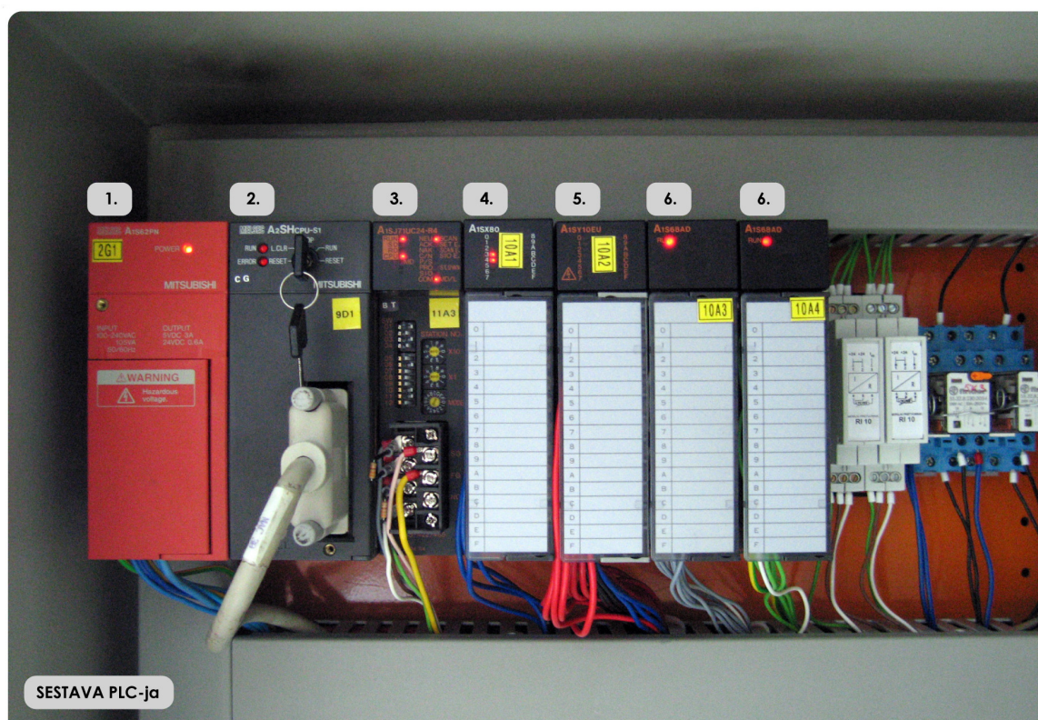
Slika 3.9: Vgrajeni moduli PLC-ja; 1. napajalnik, 2. procesna enota, 3. komunikacijski modul, 4. digitalni vhodi, 5. digitalni izhodi, 6. analogni vhodi.
