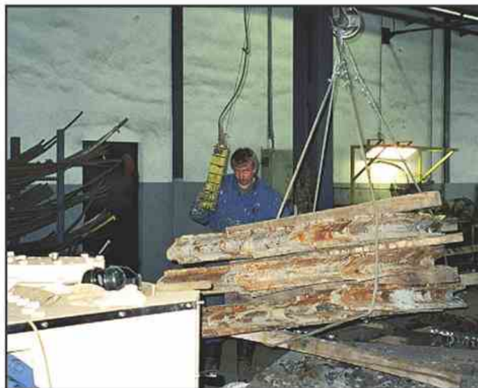
Jekleno podporje je treba večkrat pregledati.
