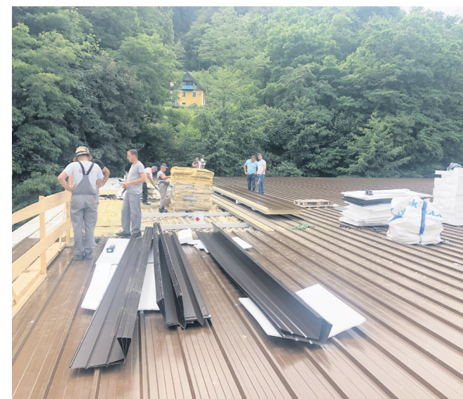
V družbi Arhitekt Ernst, ki je projektirala energetske prenove drsališča, so izračunali, da bo poraba energije za hlajenje za približno 20 odstotkov nižja. (Foto: arhiv MOC)
