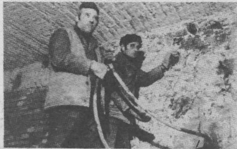
Prenovitev stanovanjske hiše Stari trg 6 – sodelovanje Tehnike in ZRMK. Posneli smo delavca ZRMK pri jačanju starih zidov s cementno suspenzijo, ki je sestavljena iz cementske, vode in opalske breče.
