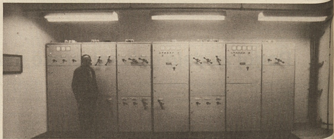
Nizkonapetostna plošča za transformatorsko postajo.
