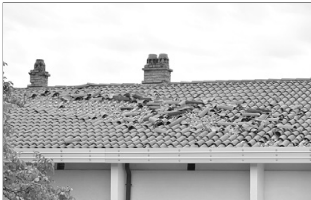
Vrtinec je avgusta najhujše poškodoval streho šolskega poslopja v Zgoniku
