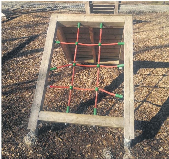
V Mestnem parku je uničeno igralo pri fitnessu na prostem. Mreža je dobesedno odtrgana in zelo nevarna.
