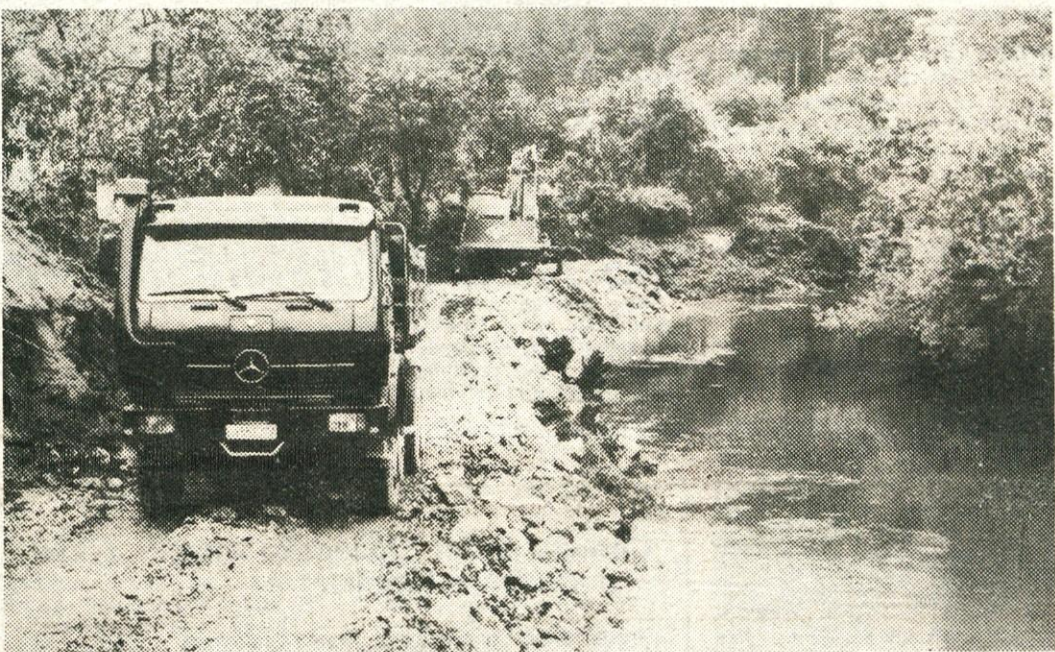
Lubija je v Verdu ogrozil nekaj hiš, pretela je nevarnost, da bi se hiše začele posedati in naglabati, zato je Območna vodna skupnost začela z utrjevanjem brežine.
