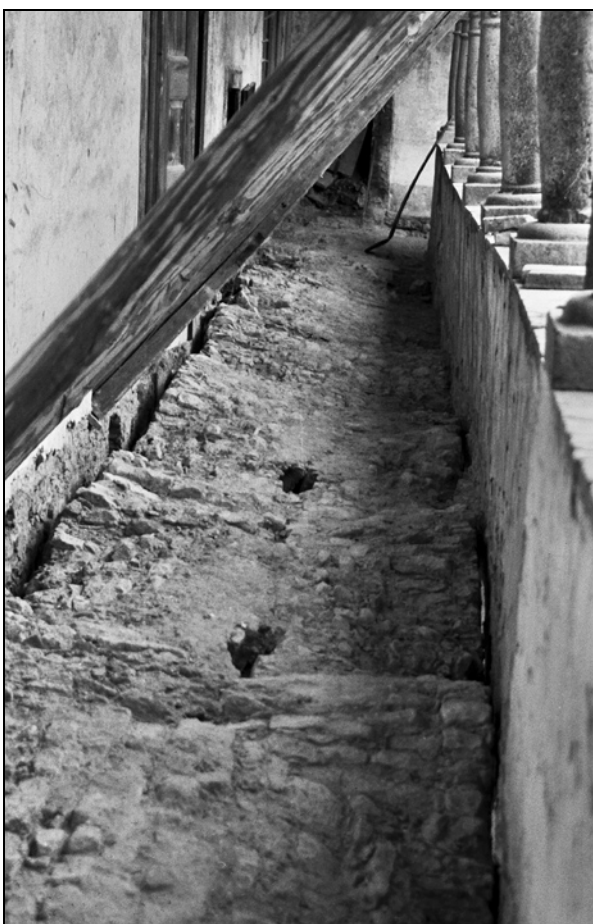
Arkadni hodnik z očiščenimi oboki; viden je odmik zidov od stene (fototeka ZVKDS, OE Kranj).
