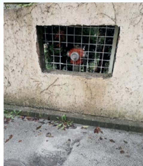
Nepravilno postavljen oz. zagrajen hidrant
