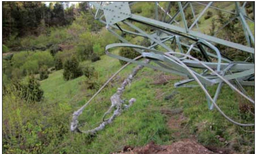
Pretrgani vodniki na stebru daljnovoda
