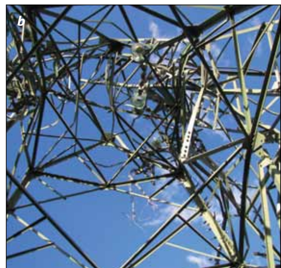
Posledice žleda na stebrih 400-kilovoltnega daljnovoda Beričevo–Divača – a in zveržena konstrukcija nosilnega stebra daljnovoda – b
