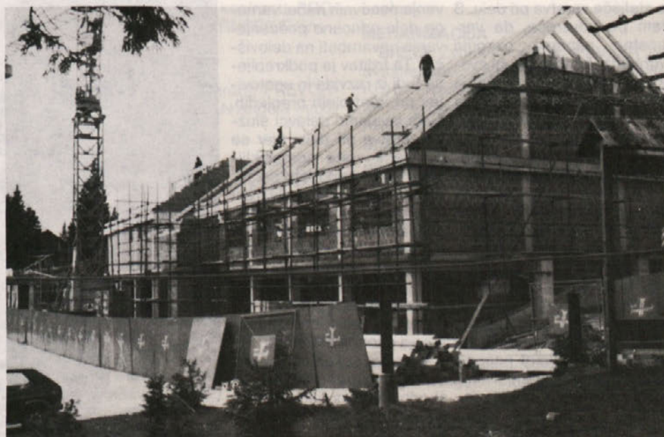
Sprejemno-zabavno-oskrbovalni center na Rogli po 40 dneh gradnje. Sedaj je objekt že v popolnoma novi podobi, je v celoti pokrit in zastekljen, zgotovljena je tudi fasada. Foto: Vili Šuster
