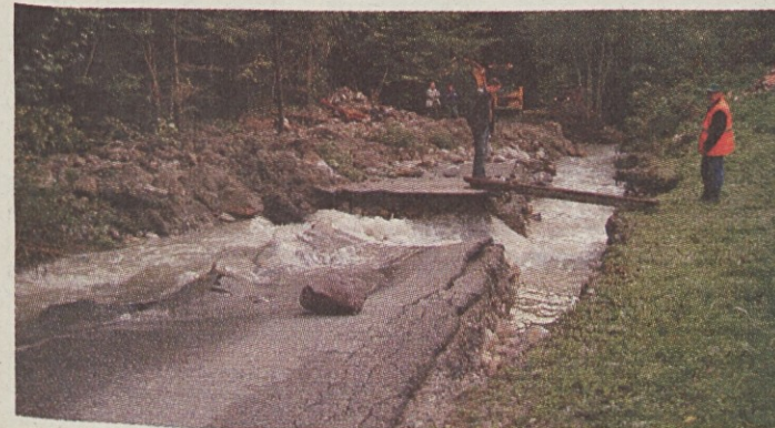
Cesta Bela - Vrhe, kjer je odtrgalo del cestišča, ki je začasno saniran z nasutjem peska. »Nihče ne ve, kdaj bo asfaltirano, niti kaj se bo zgodilo ob naslednjih poplavlavah«, pravi Semprimožnik.
