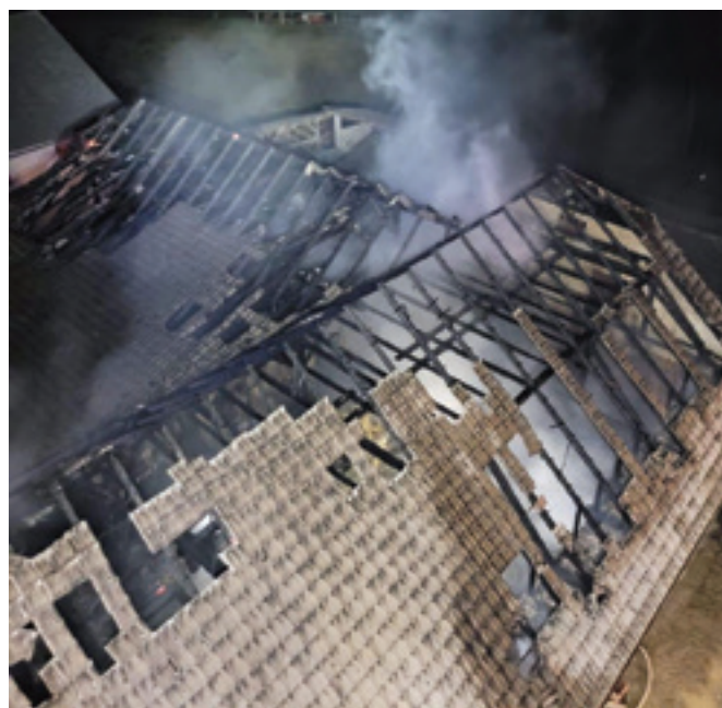
Slika 3: Uničeno ostrešje objekta
