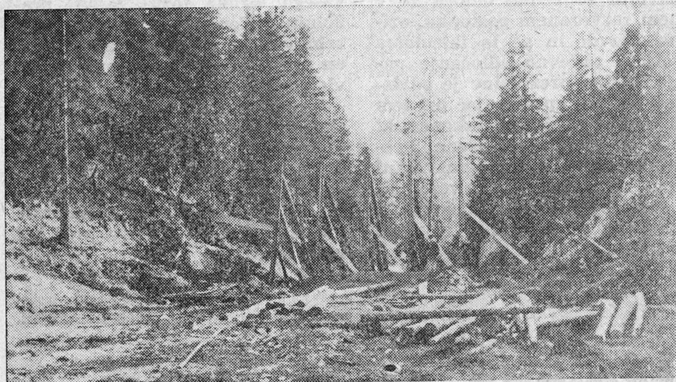
Bruna, ki bodo zadrževala velike količine vode, so že postavljena. Ogleduje si jih Miro Bavdek, tesar, ki je dela strokovno vodil. Jez bo visok 6 metrov. Miro zagotavlja, da jezero ne bo puščalo
