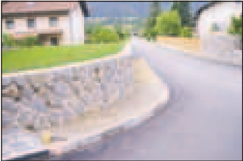
Neurejen (ni asfaltiran) pločnik
