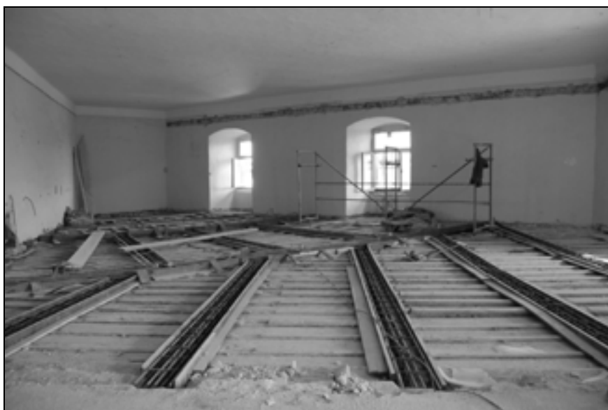
Sanacija medetažne lesene konstrukcije – lesenega tramovnega stropa med prvim in drugim nadstropjem vzhodnega trakta (foto: A. Železnik, september 2011).
