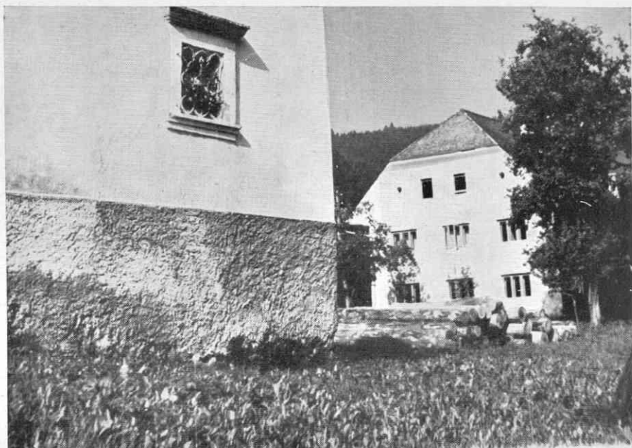
Sl. 1. Staro in novo. Na levi: del Kalanovega doma, na desni: pravkar »obnovljeni« sosedni dom; baročna okna so bila nadomeščena s trodelnimi ležečimi, vlaga pa kljub temu nezadržno ogroža konstrukcije
