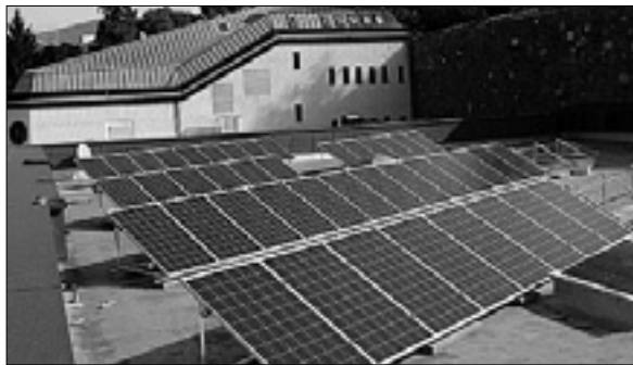
Fotovoltaični paneli na strehi Kulturnega doma
