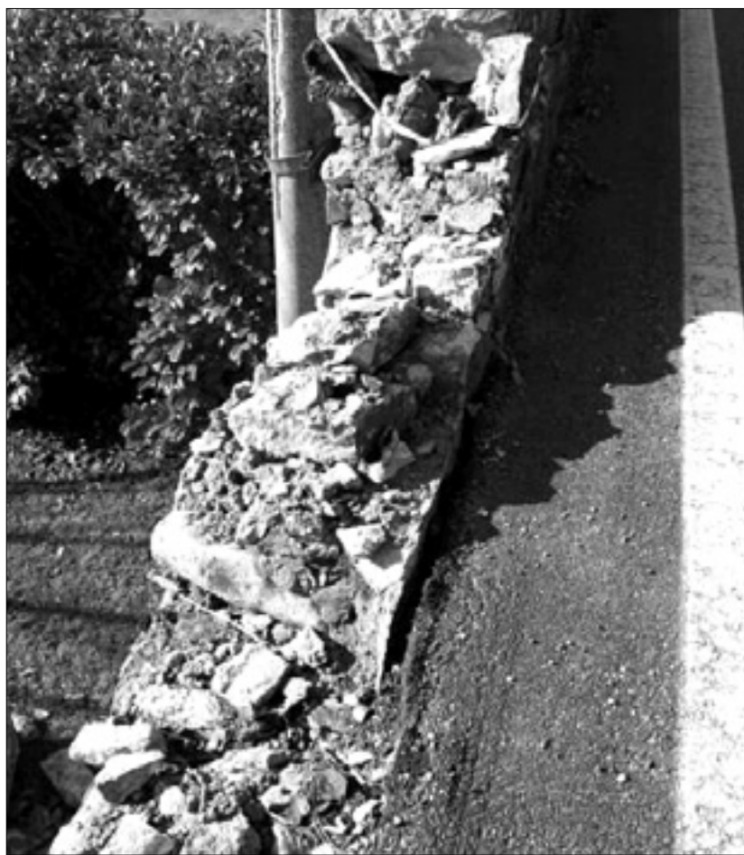
Na več mestih porušeni občestni zidek
