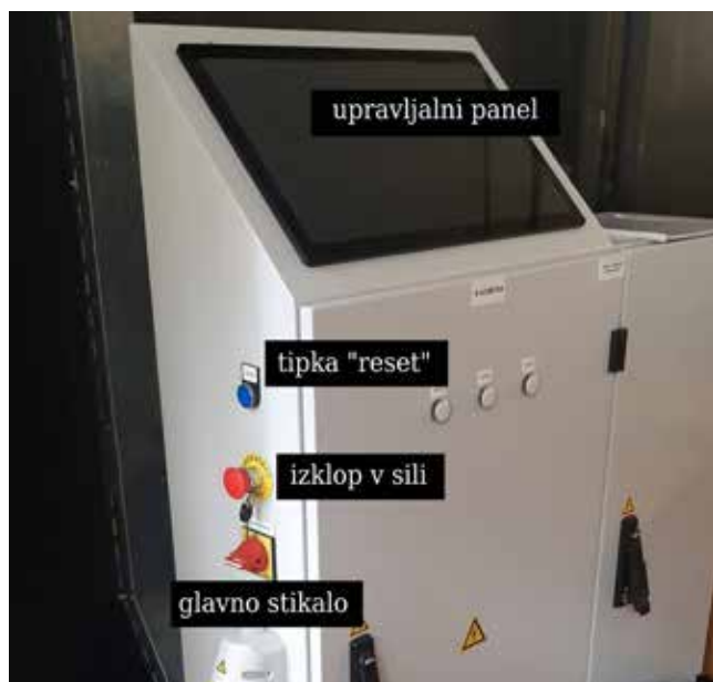
Slika 4 : Centralna nadzorna enota
