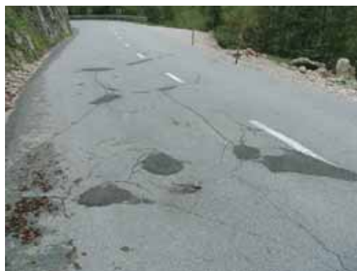
Sl. 4. Poškodba vozišča, kjer so bila nujna obsežnejša vzdrževalna dela (pri žičnici Golobar).
