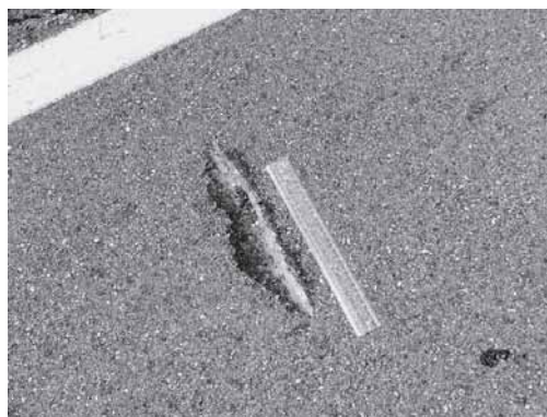
Sl. 3. Poškodba na vozišču (dolžine približno 30 cm), ki jo je povzročila padajoča skala.
