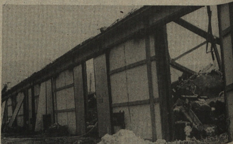
Od velikega skladišča v pristanišču je ostal le še kakšen zid. Neprimerna zidava na slabo nosljivih tleh je povzročila svoje
